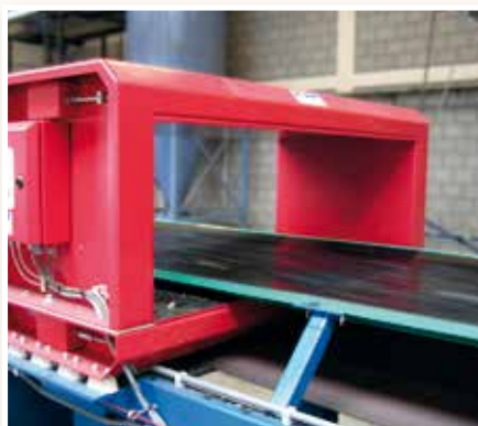
Montaż detektora metali. Wyraźnie widać strefę wolną od metali
